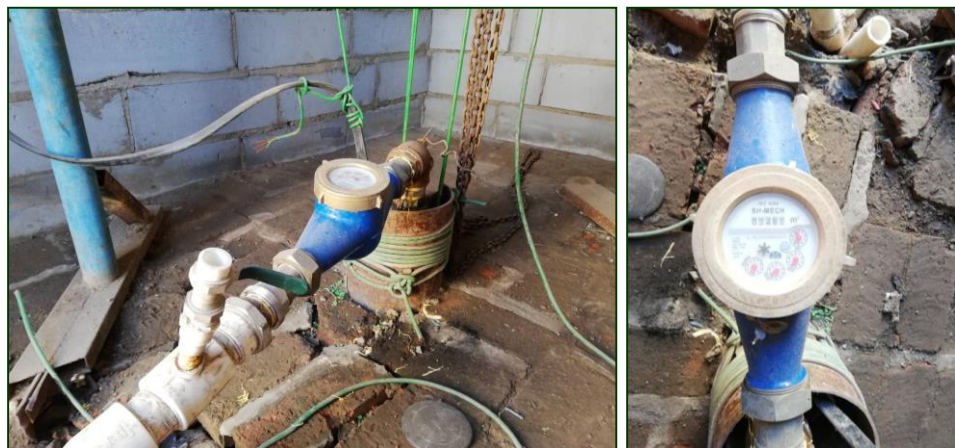
Зураг 9. Унд ахуйн гүний худгийг тоолууржуулсан байдал
