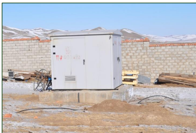
Зураг 11. Үйлдвэрийн 400 кВа-ийн дэд станц
