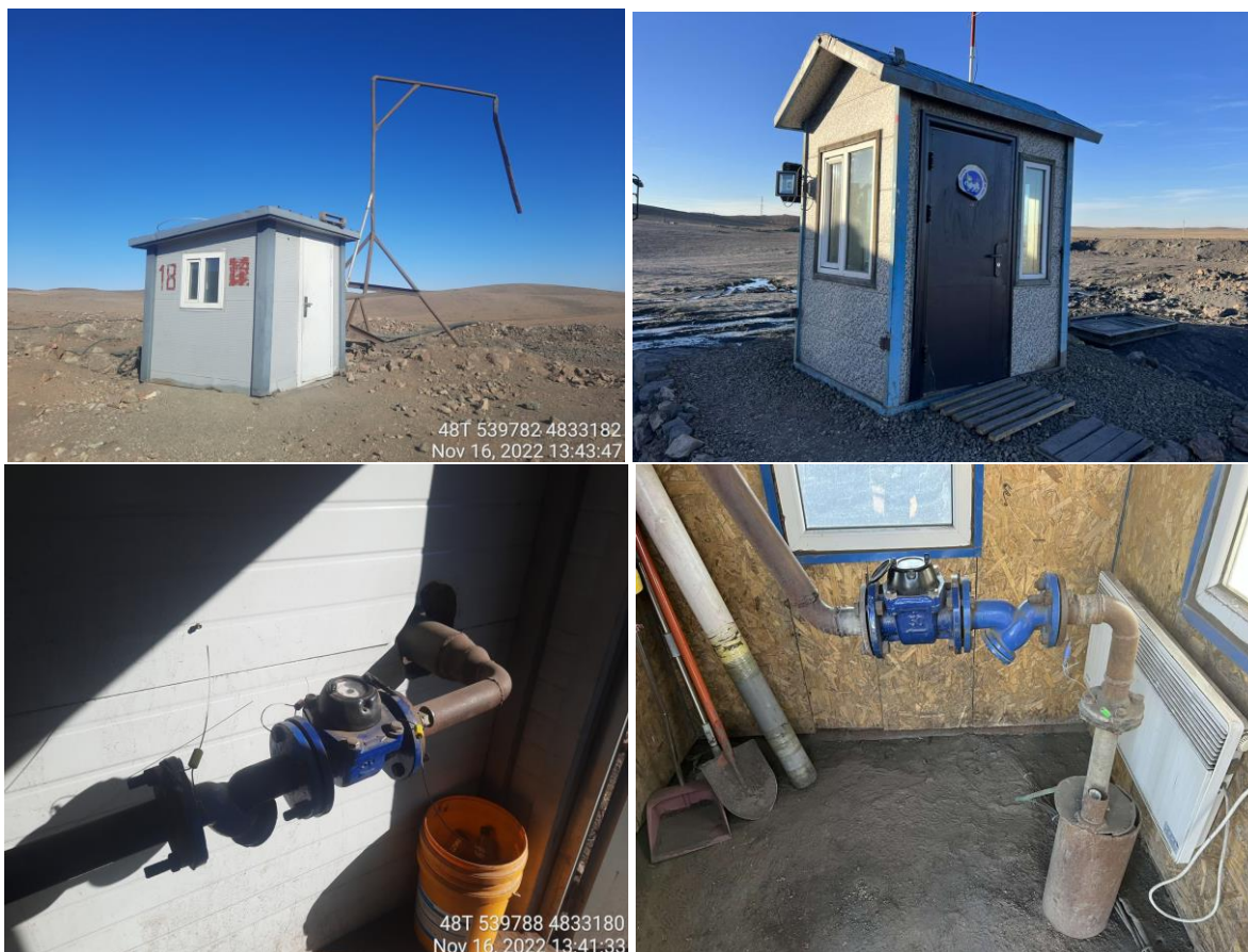
Зураг 2.10-2.13 Ус ашиглах, ашиглуулах гэрээний дагуу инженерийн хийцлэл бүхий байр, тоноглол, баталгаат тоолуур суурилуулсан №18, №05 гүний худгийн байгууламж
