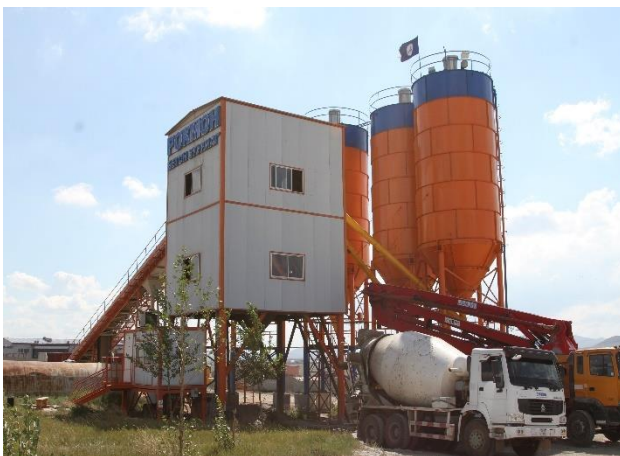
150м 3 /цаг бетон үйлдвэрлэх хүчин чадалтай үйлдвэр
