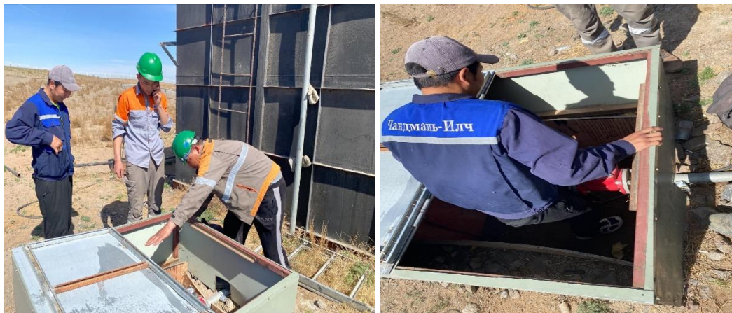
Зураг 9. “Чандмань Илч” ХХК тоолуур суурилуулж буй байдал
