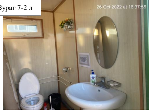
Ариун цэврийн өрөөнүүдэд гар угаах хэрэгсэл байршуулсан байдал
