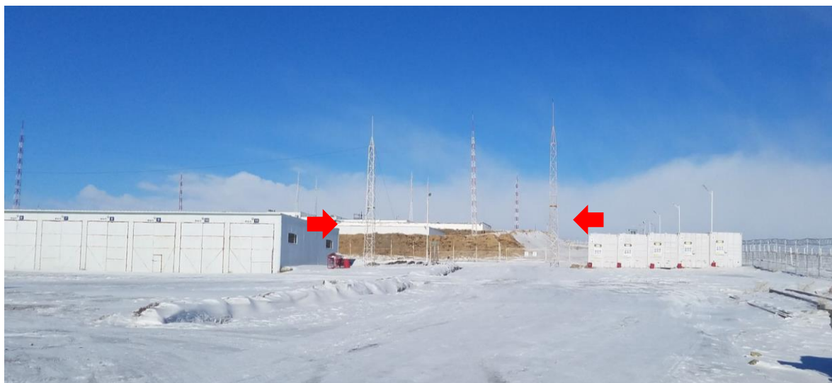
Зураг 12. Төслийн талбайн барилга байгууламж болон аянга зайлуулагчид
