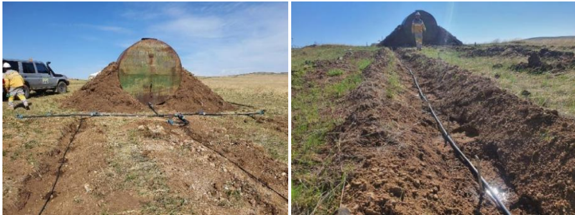
Зураг 20. Хамгаалалтын ойн зурвасын усалгааны 25 тонны ёмжмост
