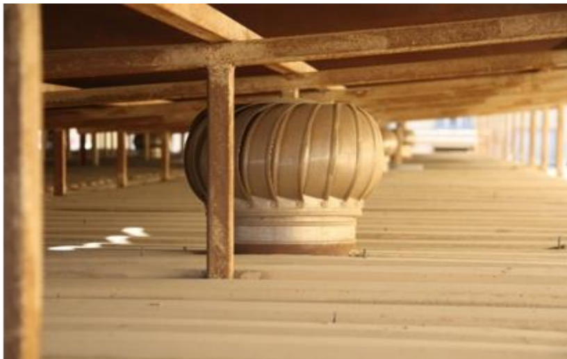
Агуулахын механик вентилятор
