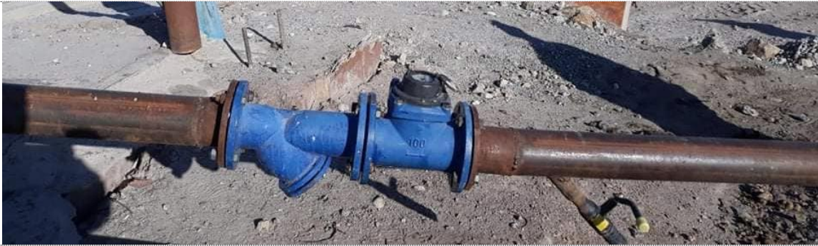
Тоолуур байршуулсан байдал
