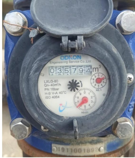
Зураг 12 ХЦ-4 худагт суурилуулсан усны тоолуур
