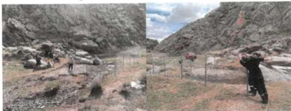
/ Үенч сумын Нарийн гол багт Байшинт адаг усны бүлгийн эхийг хашиж хамгаалах ажил/
