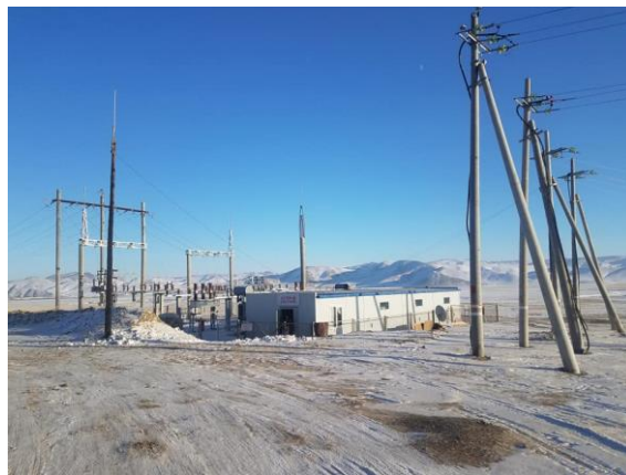
Зураг 11, 12. Дэд станц
