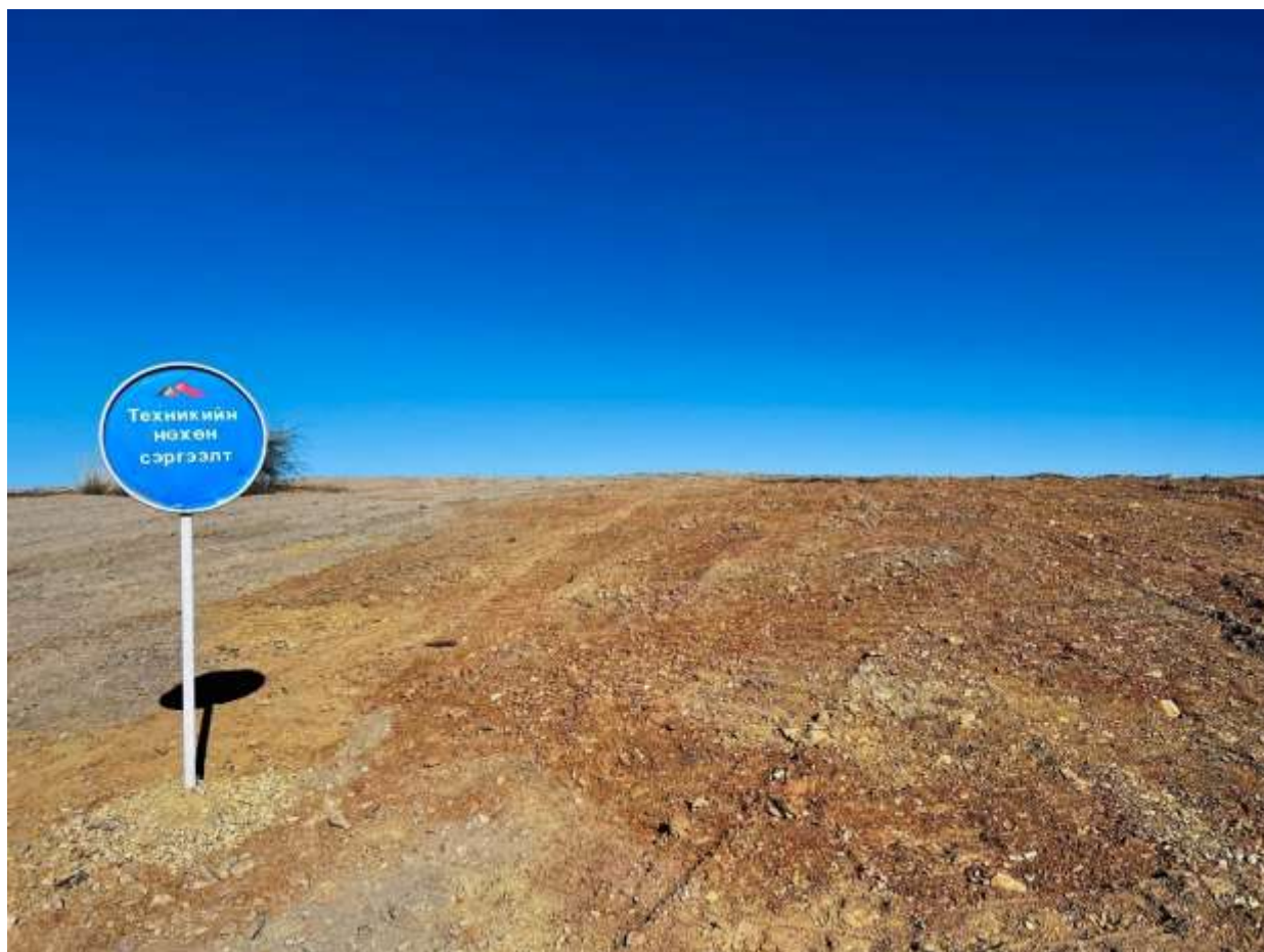
Зураг 25 Ухшийг дүүргэх, хурдас чулуулгийн овоолгыг намсгах, ирмэгийг налуулах, тэгшлэх, хэлбэршүүлэлтийн ажил явагдаж байна.
