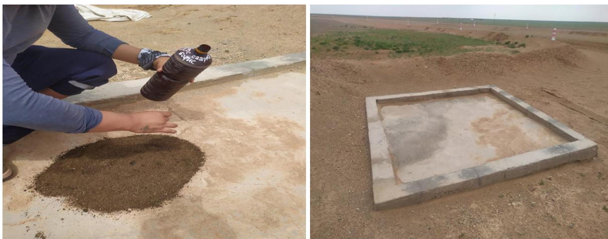
Зураг 15. Тосоор бохирдсон хөрсийг зориулалтын талбайд саармагжуулж буй байдал
