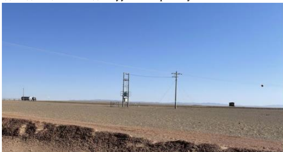
Зураг 5. Уурхайн дэд станц
